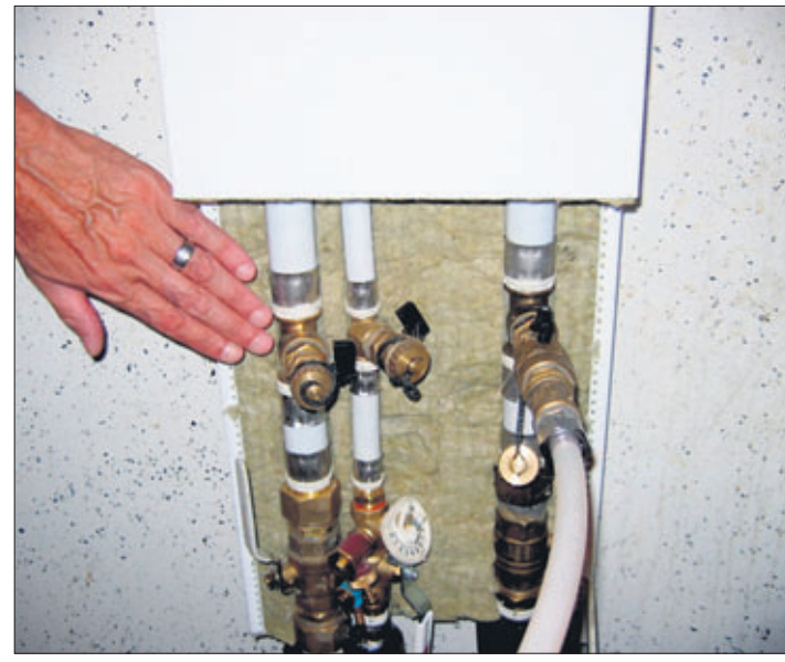
As Oy:n Tornitalossa putkistosaneeraus toteutetaan Uponor-komposiittijärjestelmän käyttövesi- ja viemäriputkilla asennettuina PipeModulin AS-elementteihin . Uudet putket ja johdot verhoetaan siisteihin sisustuselementteihin . Kuva: Juha Karila.
