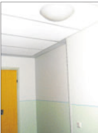
Rappukäytävä on tyylikäs ja vesiputket ovat sijoitettu koteloihin. Tulevaisuudessa ne on helpoita huoltaa.
