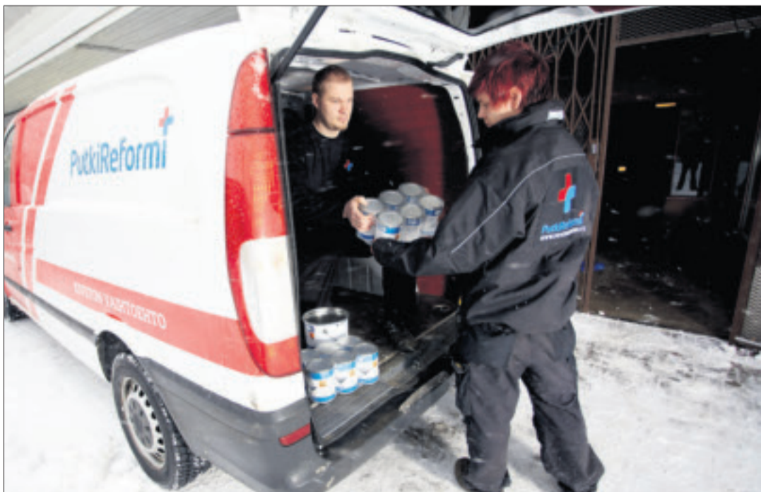
PutkiReformi käyttää menetelmään VTT-sertifioitua pinnoitusmenetelmää ja sukkaajutusmenetelmää, joissa hyödynnetään vanhat putket ilman muutostöitä talon rakenteissa.
