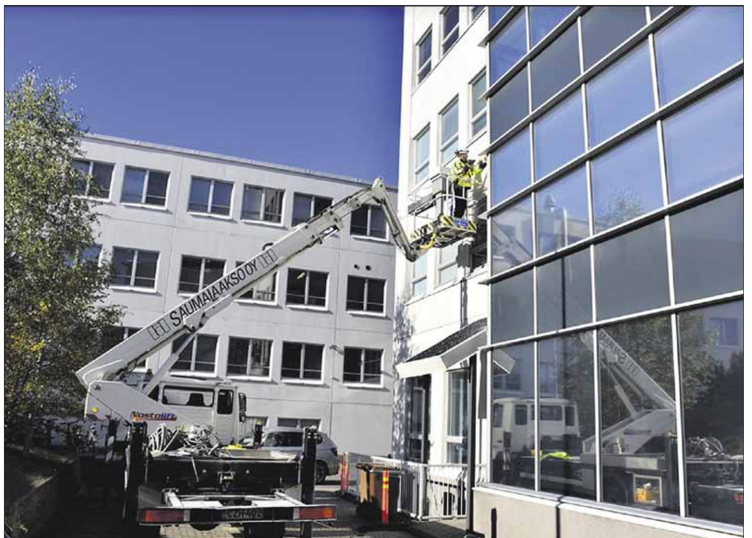
Elementtisaumaukset voidaan suorittaa ilman telineitä henkilönostimilla. Se on varsin nopea julkisivun huoltotoimenpide. Kuva: Saumalaakso Oy.
